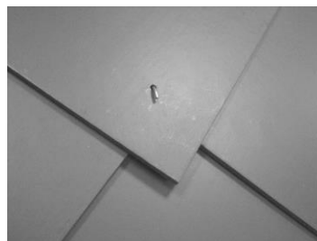
Pose de l'ardoise en losange au-dessus du crampon-tempête qui est plié vers le bas ; ne pas trop serrer de façon que les ardoises puissent encore bouger.
